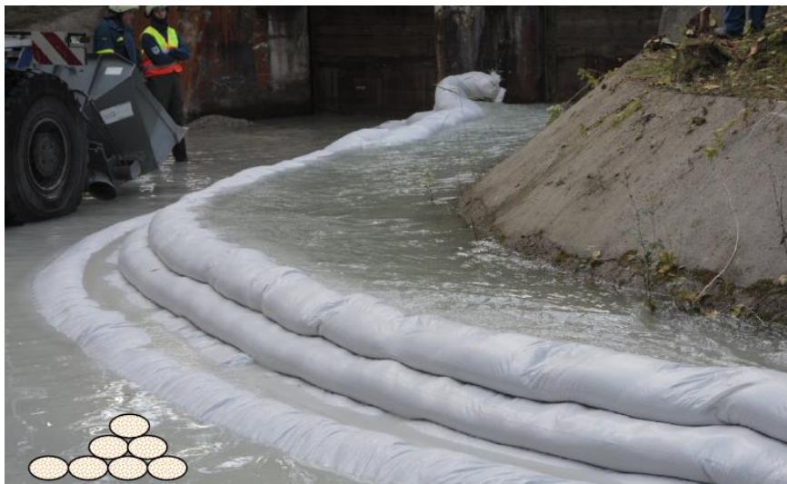
Damm, 3-lagig, auf der Kurveninnenseite druckbelastet durch „randvollem Abfluss“
